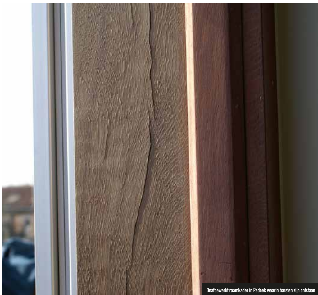
Onafgewerkt raamkader in Padoek waarin barsten zijn ontstaan.
