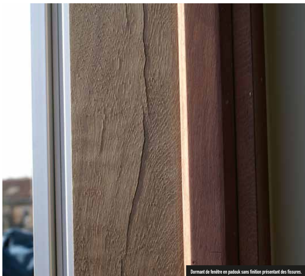
Dormant de fenêtre en padouk sans finition présentant des fissures.
