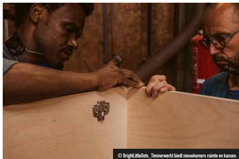
© BrightLittleDots - Timmerwerk biedt nieuwkomers ruimte en kansen.
